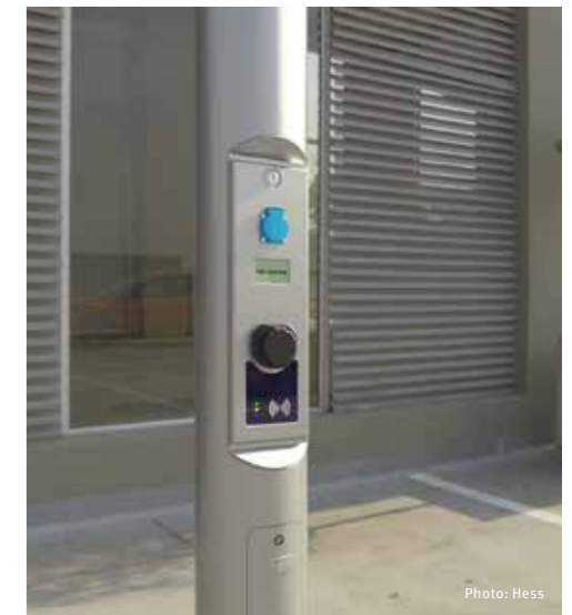
Une station de recharge électrique: parfaitement intégrée dans une colonne lumineuse.
